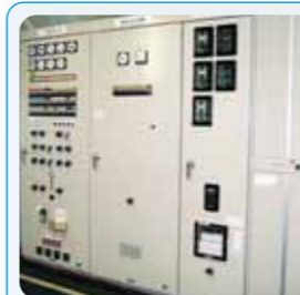
水力発電所水車・ 発電機制御装置
