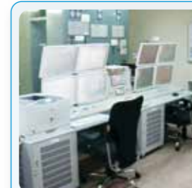
発電所・ダム・水系 遠隔監視制御システム
