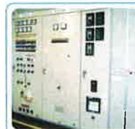
水力発電所水車・ 発電機制御装置
