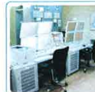
発電所・ダム・水系 遠隔監視制御システム
