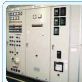
水力発電所水車・ 発電機制御装置
